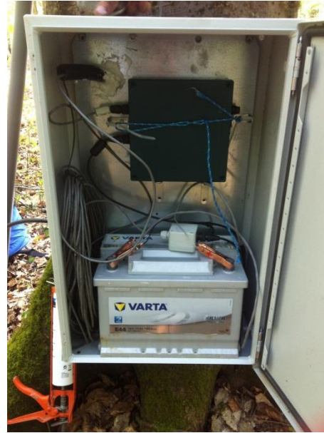
Photo 7. Coffret installé au pied de l'arbre
